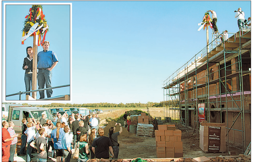
Die Zimmerleute hängen, beobachtet von den Festgästen, den Richtkranz auf (großes Bild). Anschließend dankt Firmenchef Marc van Eupen zusammen mit Lebensgefährtin Melanie Schoedon vom Dach aus für das Kommen (kleines Bild).
